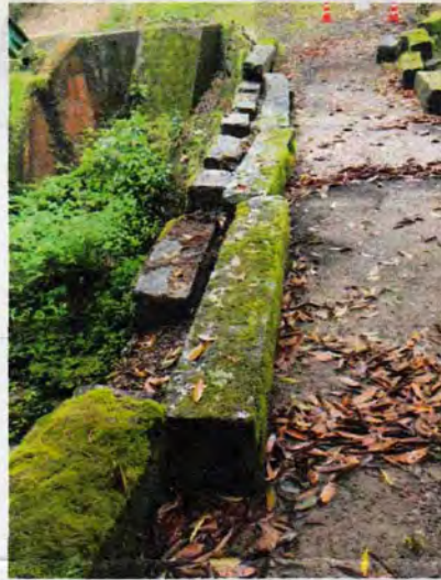
馬門橋(今)町指定 欄干損壊、落下。輪石は残存。 通行禁止。
