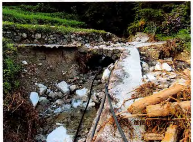
西の鶴橋(美里町甲佐平)無指定 流木が流れた後在り。上流に土砂が迫っている。下流域は、土砂崩壊。
