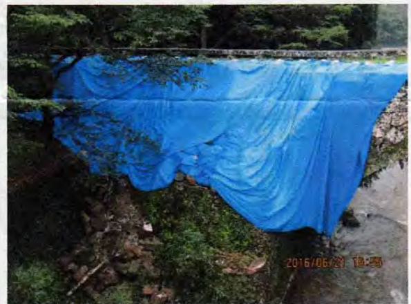
八勢橋(上益城郡御船町) 6月21日見た時はすでにビニールシートがかぶ せてあり、壁石から上部が大きく崩落している 模様
