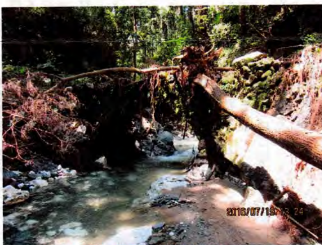
白岩橋(美里町甲佐平)無指定 流木が引っかかっている。輪石・壁石は、かろうじて残っている。
