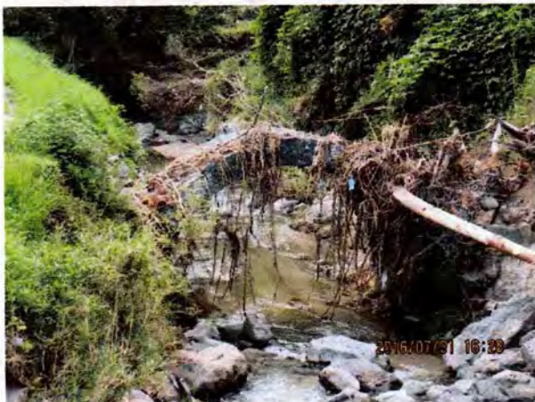
下由来橋(美里町川越)無指定 流木が引っかかっている。輪石のみ辛うじて残っている。
